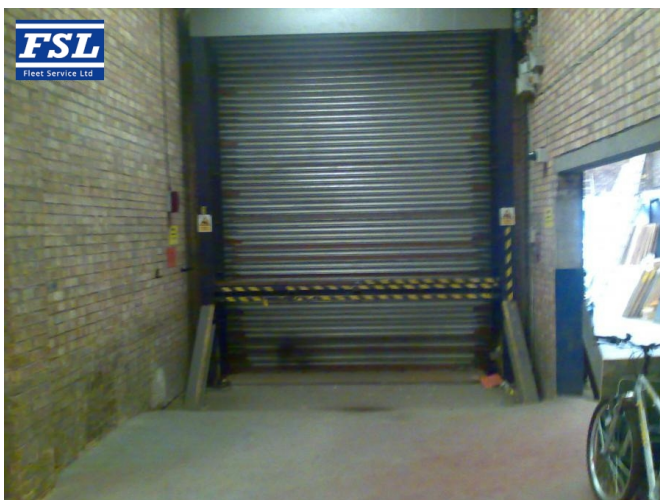
Roller Shutter Door
